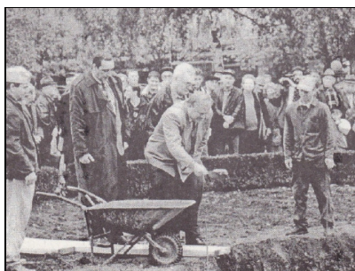
5 octombrie 1998. Prefectul Romeo Octavian Hanganu, asistat de inginerul Octavian Porumb și de Victor Horia Toma, primarul Ploieștilor, toarnă istoricul cancioc de beton la fundația platformei monumentului Poetului Nichita Stănescu
