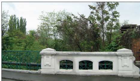
Fig. 291. Bârlad (jud. Vaslui). „Podul Verde” construit din beton armat și metal, în prima jumătate a secolului al XIX-lea (Foto: 2010)
