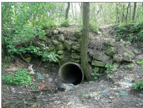
Fig. 174. Turturești (jud. Neamț). Podul de piatră atribuit lui Ștefan cel Mare (Foto: 2006)
