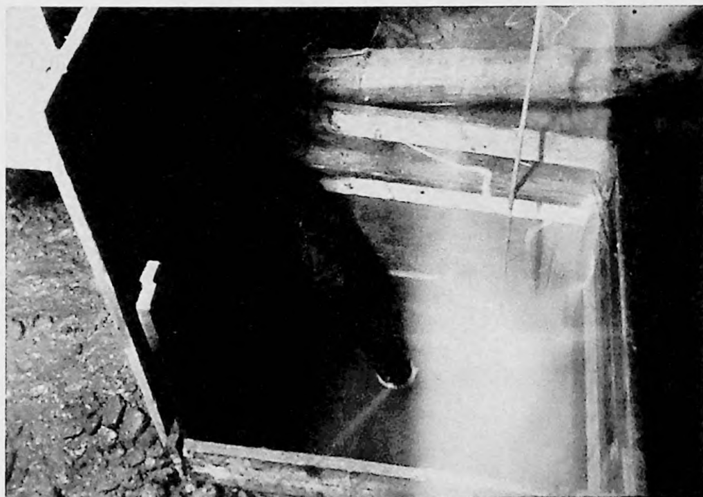
37. Valea Voicului - Pila 4. Puț pentru colectarea apei în timpul betonării fundației/ 31 octombrie 1948
