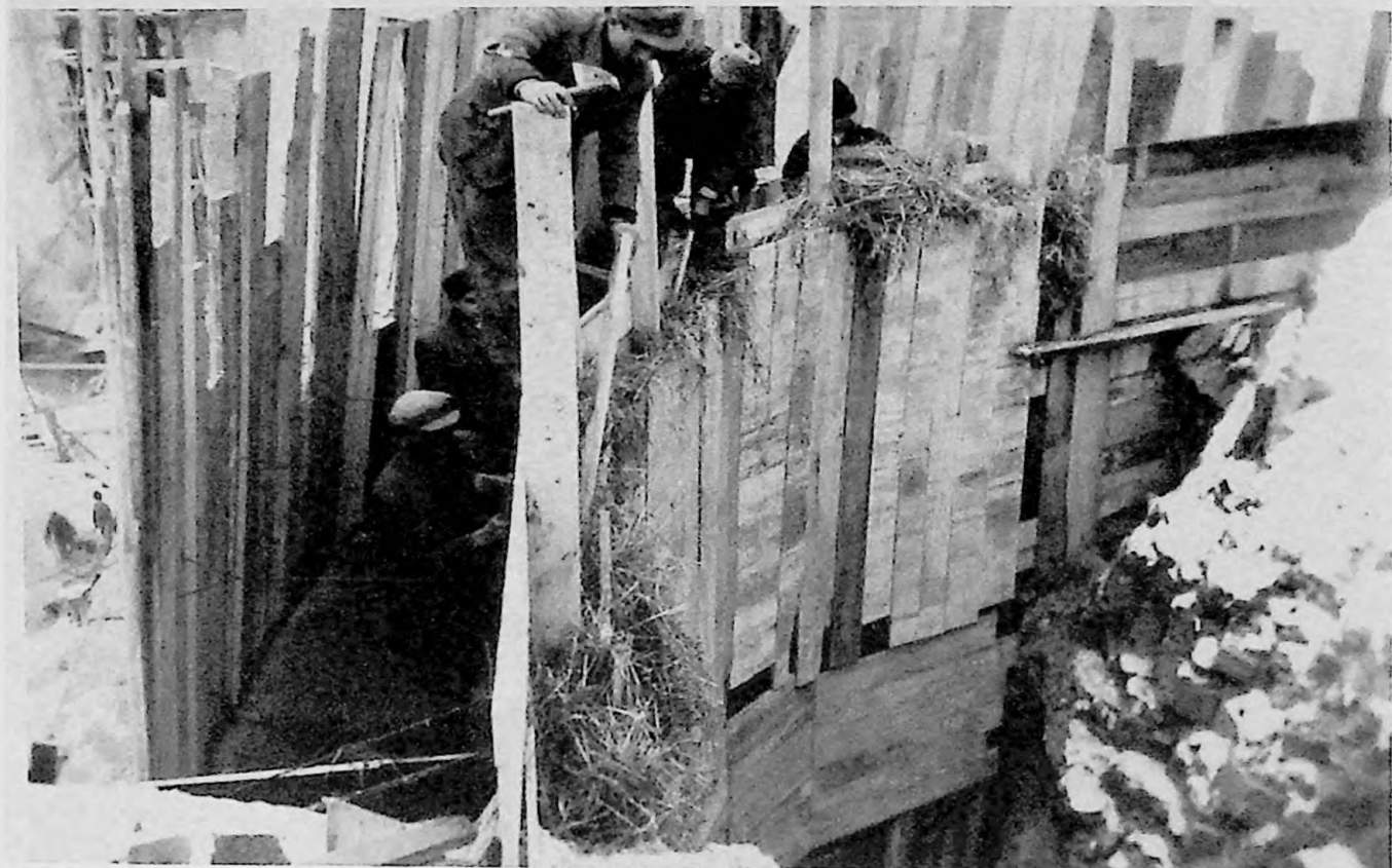
87. Valea Voicului - Zidul de racordare cu pila 1. Betonare pe îngheț. Cofraj dublu umplut cu paie/ 2 decembrie 1948
