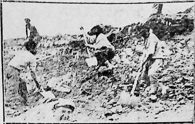
La terasament la fel ca și la celelalte munci, brigadierii de pe Șantierul Național „Vasile Luca” Salva-Vișcu se străduiesc să-și ducă munca la bun sfârșit
