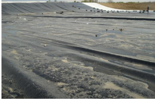
Figura 2.39 - Cute apărute la instalarea geomembranei (Mofleni)
