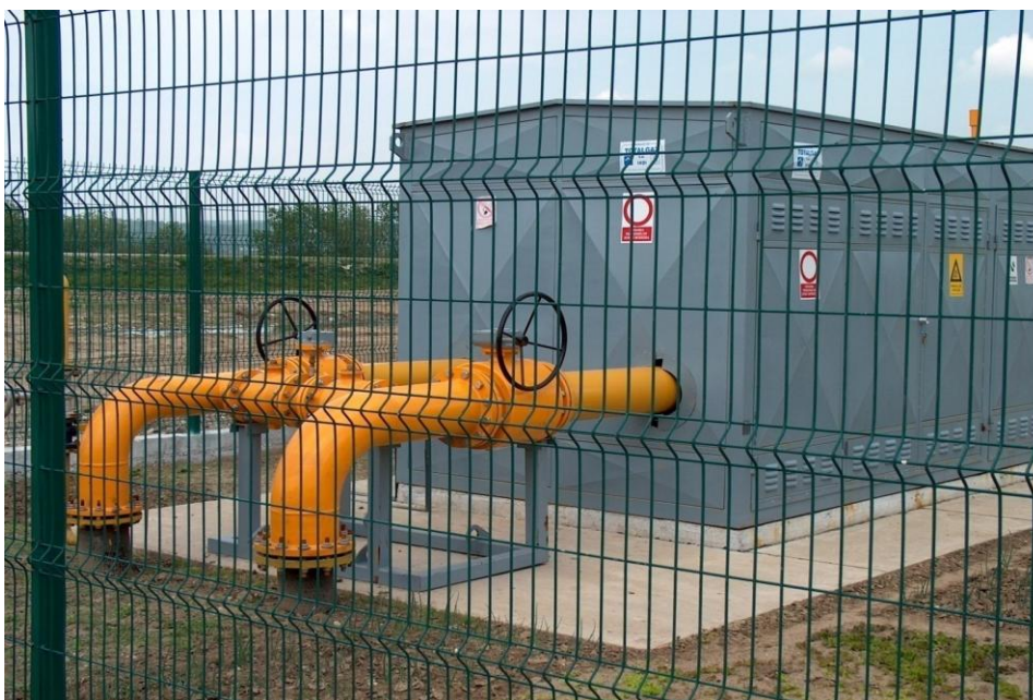
Fig. 2.30. Stație de reglare gaze de sector dotată cu diferite filtre
